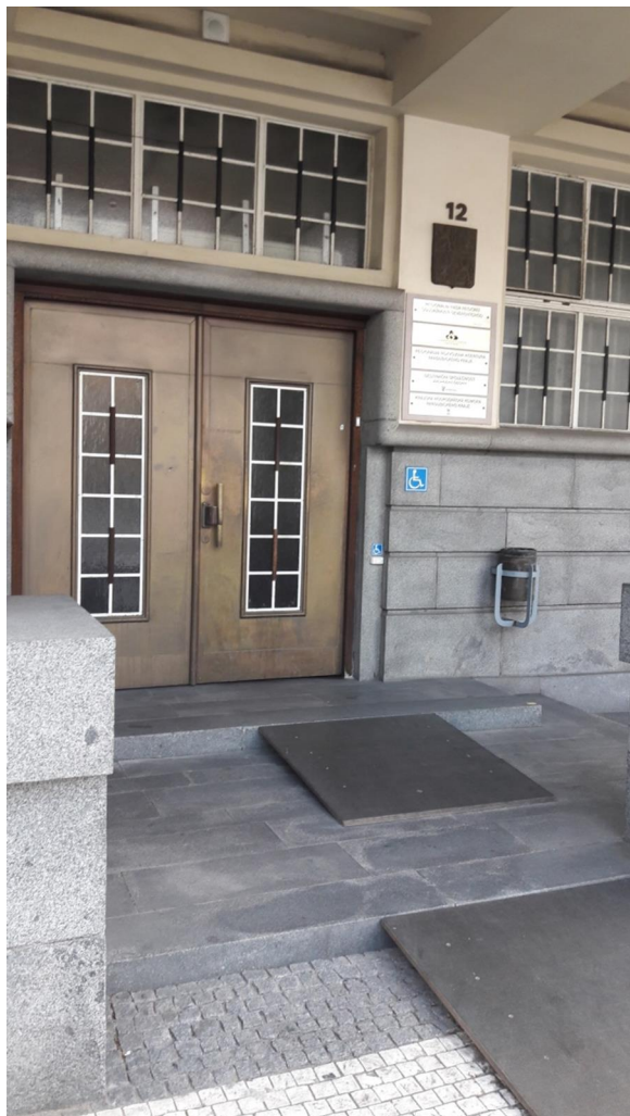
Nepřístupný hlavní vstup (z nám. Republiky 12) Za vstupem rampa ( nebezpečné - velký sklon )
